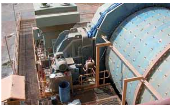
Antriebe für Rohmühlen müssen sehr hohe Leistungen bereitstellen können
