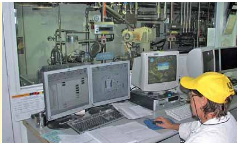
Die Zuverlässigkeit und Flexibilität von Simatic PCS 7 und Simatic Batch tragen zu einer erheblichen Steigerung der Produktivität der Anlage bei
